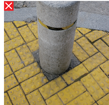
그림 46. 점자블록 위로 블라드가 설치되어 안전한 통행을 방해
